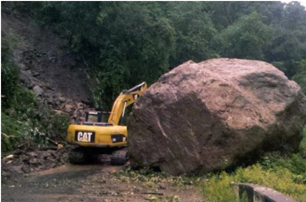
Figura 5: Caída de roca de gran tamaño obstruye el paso en km 40 de la ruta. La Voz - Inmensa roca obstruye la ruta de Tafí del Valle (9 de febrero de 2012).
