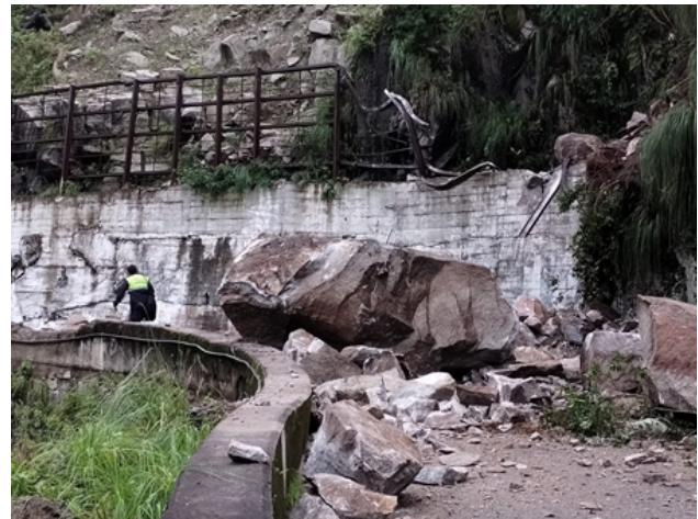
Figura 3: Caída de roca de gran tamaño en "El Fin del Mundo", km 31 de la ruta. La Gaceta - Habilitaron el tránsito en la ruta 307 tras el derrumbe en el "Fin del Mundo" (26 de marzo de 2023).
